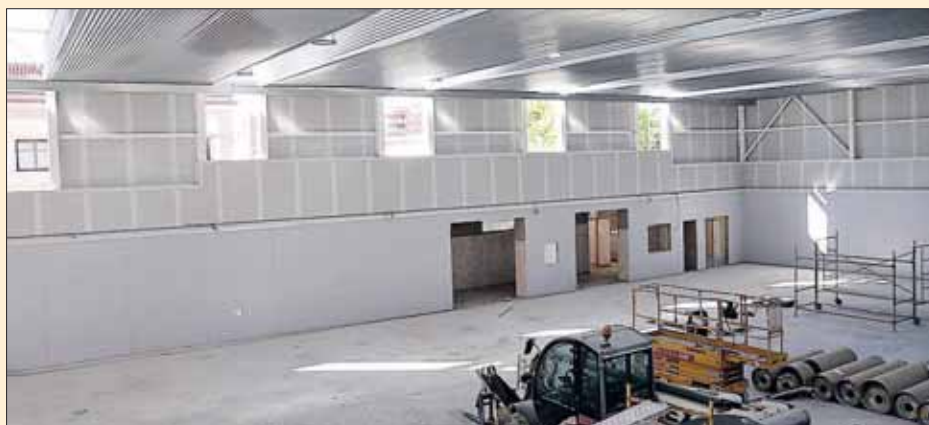
Los trabajos en el pabellón deportivo del colegio El Peñasal están parados. / JUAN MARTIN
