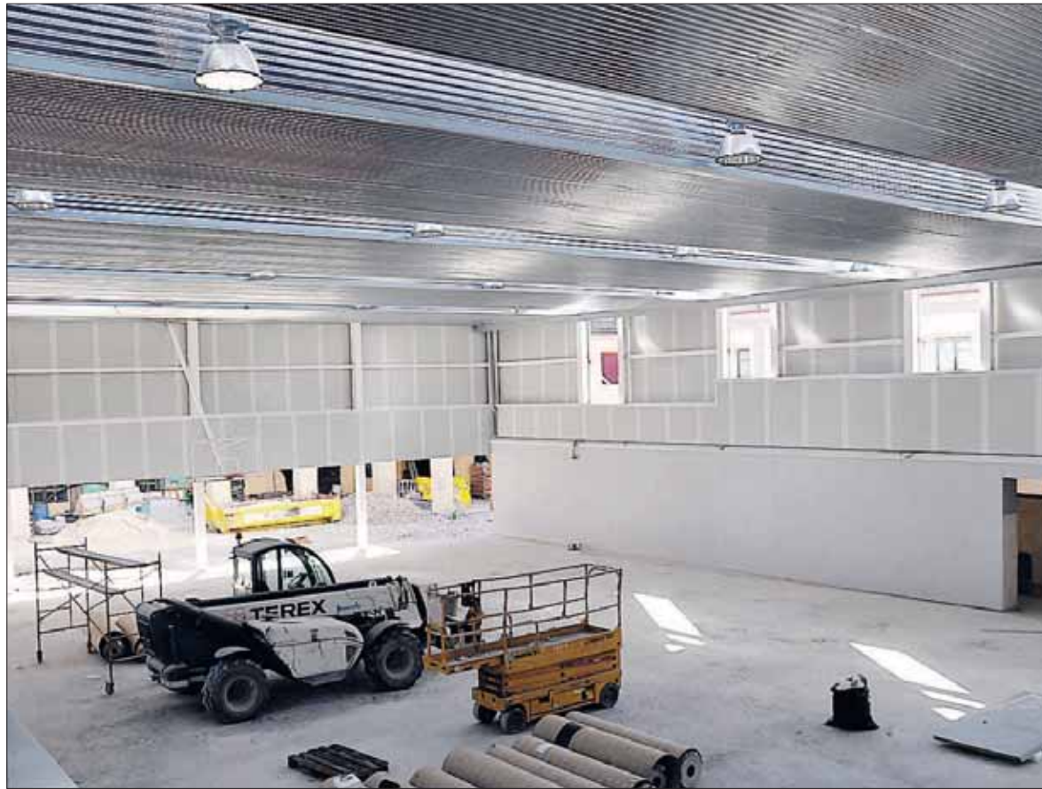
Las obras están prácticamente terminadas, a falta de algunos remates, según aseguró De Santos. / JUAN MARTÍN
