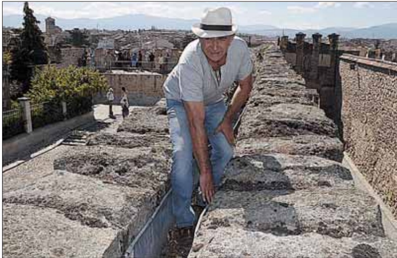
En la Plaza de Avendaño, las filtraciones de agua obligaban a intervenir. / J. MARTÍN
