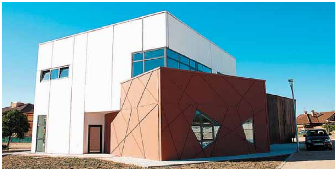
Edificio de Usos Múltiples del que se derrumbó un falso techo cuando estaban los niños del campamento. / E. A.
