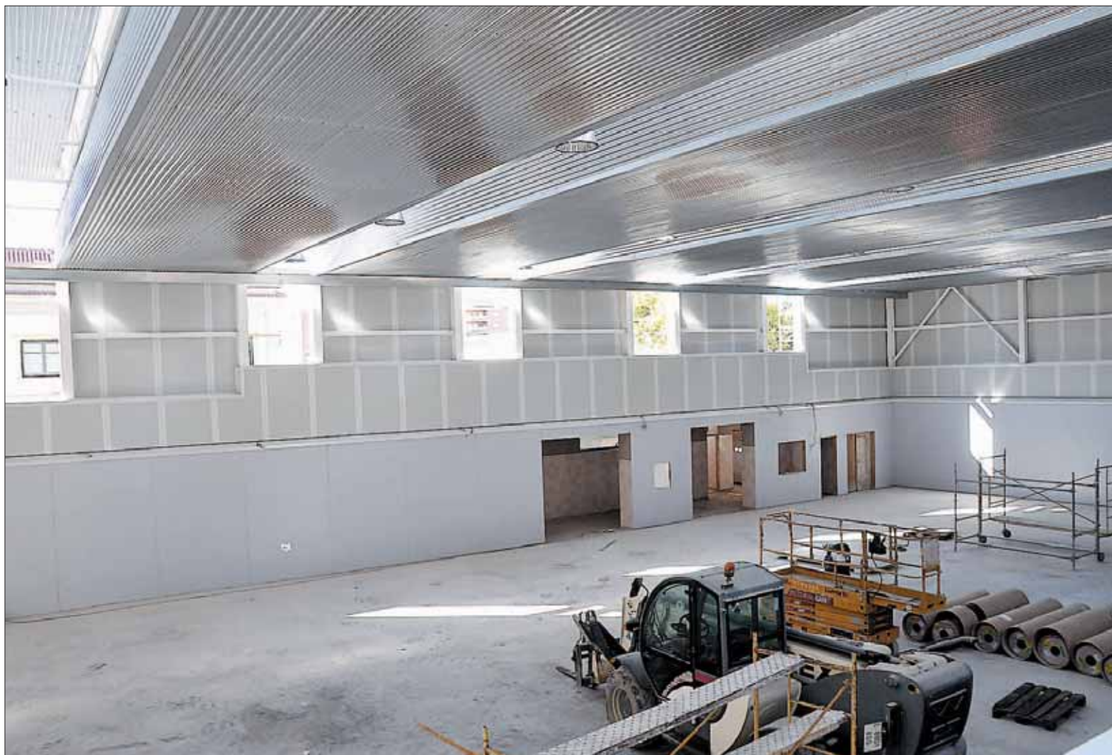
Última imagen del interior del pabellón que comenzó a construirse en diciembre de 2010, con un plazo de ejecución de 10 meses, y sigue sin terminarse. / JUAN MARTIN
