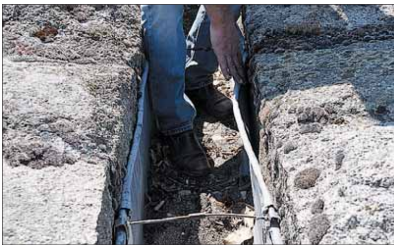
El canal de plomo se encuentra gravemente deteriorado. / JUAN MARTÍN
