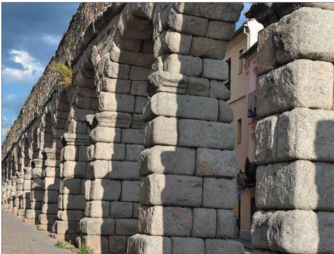
Tramo del Acueducto junto a la plaza de Día Sanz, donde se intervendrá para impermeabilizar el canal. / BORJA MARTÍN
