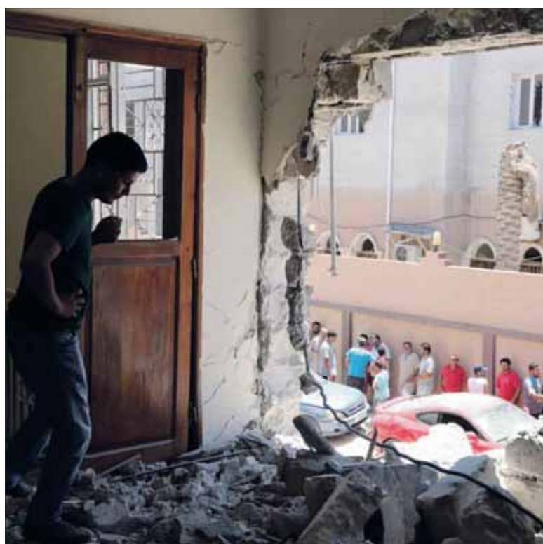
Revisan un edificio que resultó afectado tras el impacto de granadas. /EFE
