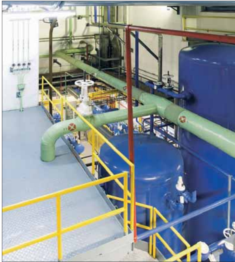
Interior de la central nuclear de Santa María de Garoña. / EP.
