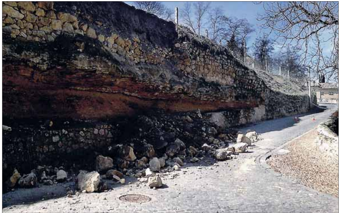
Los cascotes aún permanecen en la calzada, cortada al tráfico tras el desprendimiento de parte del muro. /EL ADELANTADO
