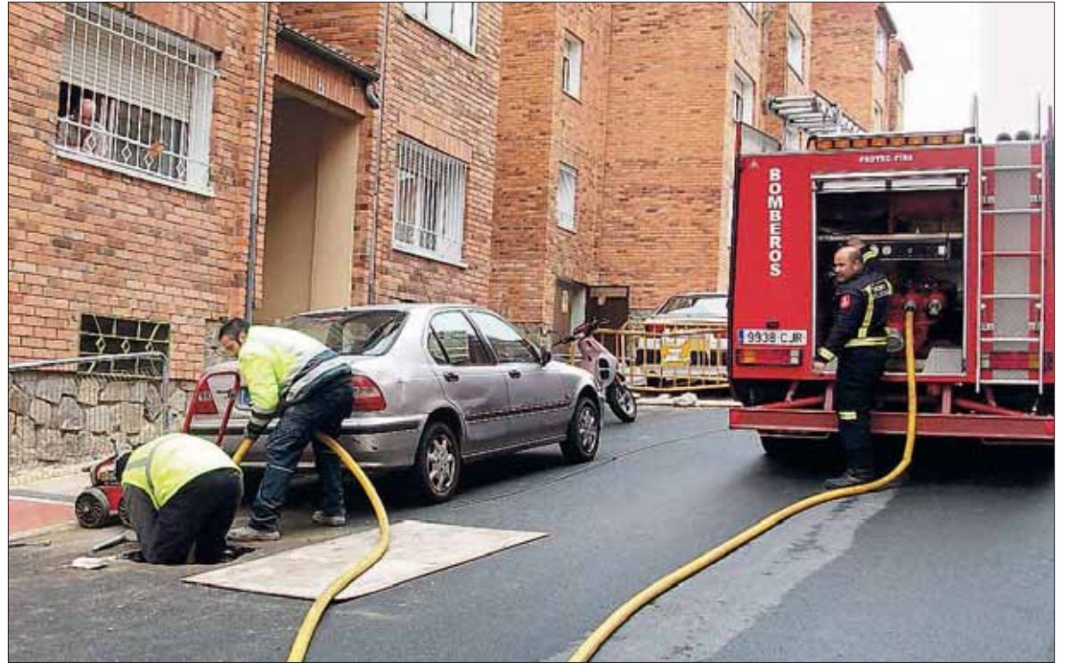
Los bomberos de Segovia durante una de sus actuaciones motivadas por averías en la red de tuberías. /EL ADELANTADO
