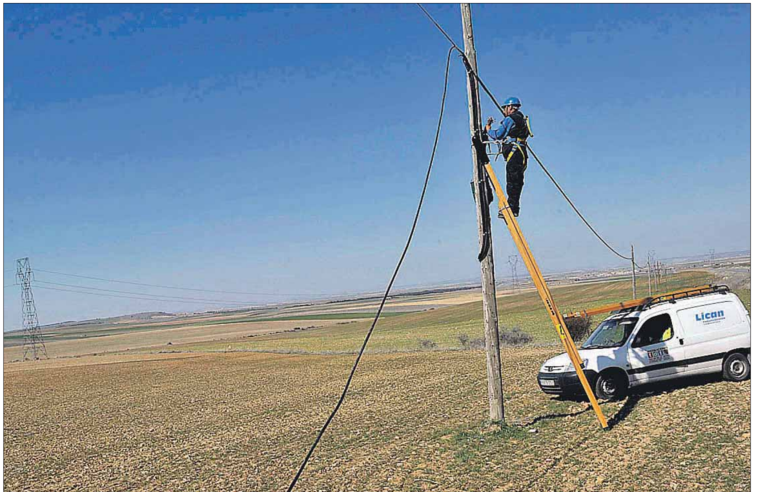
Un operario intenta reponer el cableado telefónico en un sabotaje anterior ocurrido en la zona norte de la provincia. / KAMARERO
