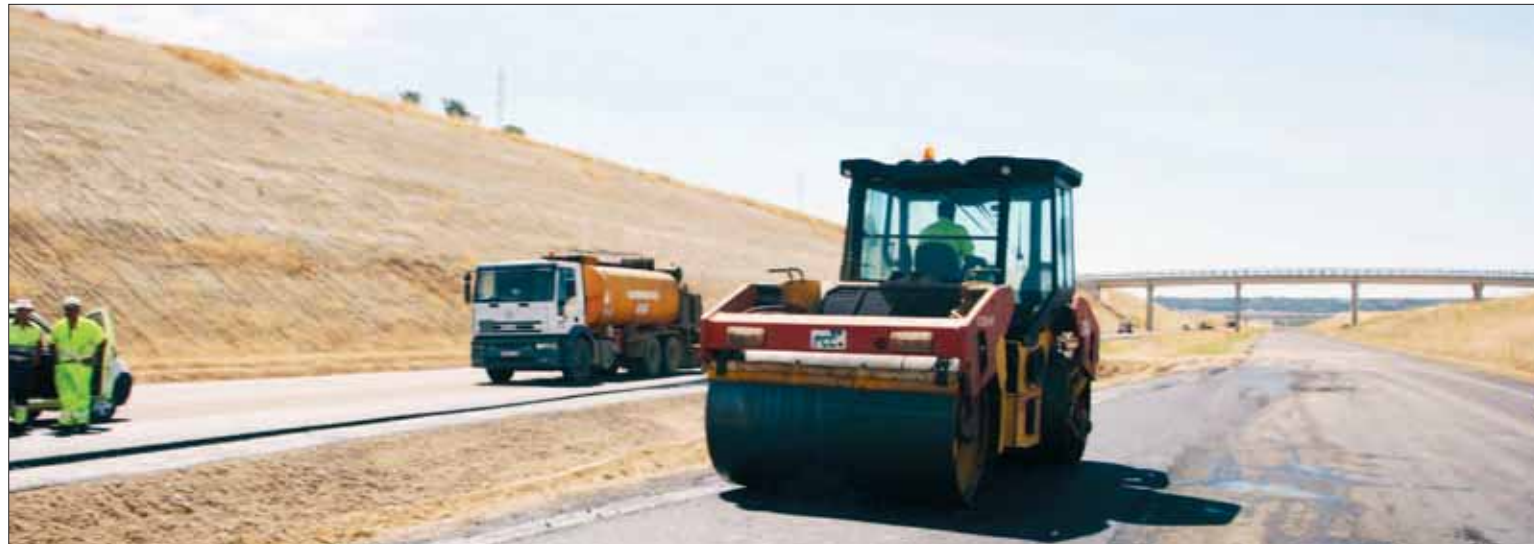
Imagen de las obras que se encuentran actualmente en marcha para concluir la Ronda Exterior Este de Valladolid. / RUBÉN CACHO (ICAL)
