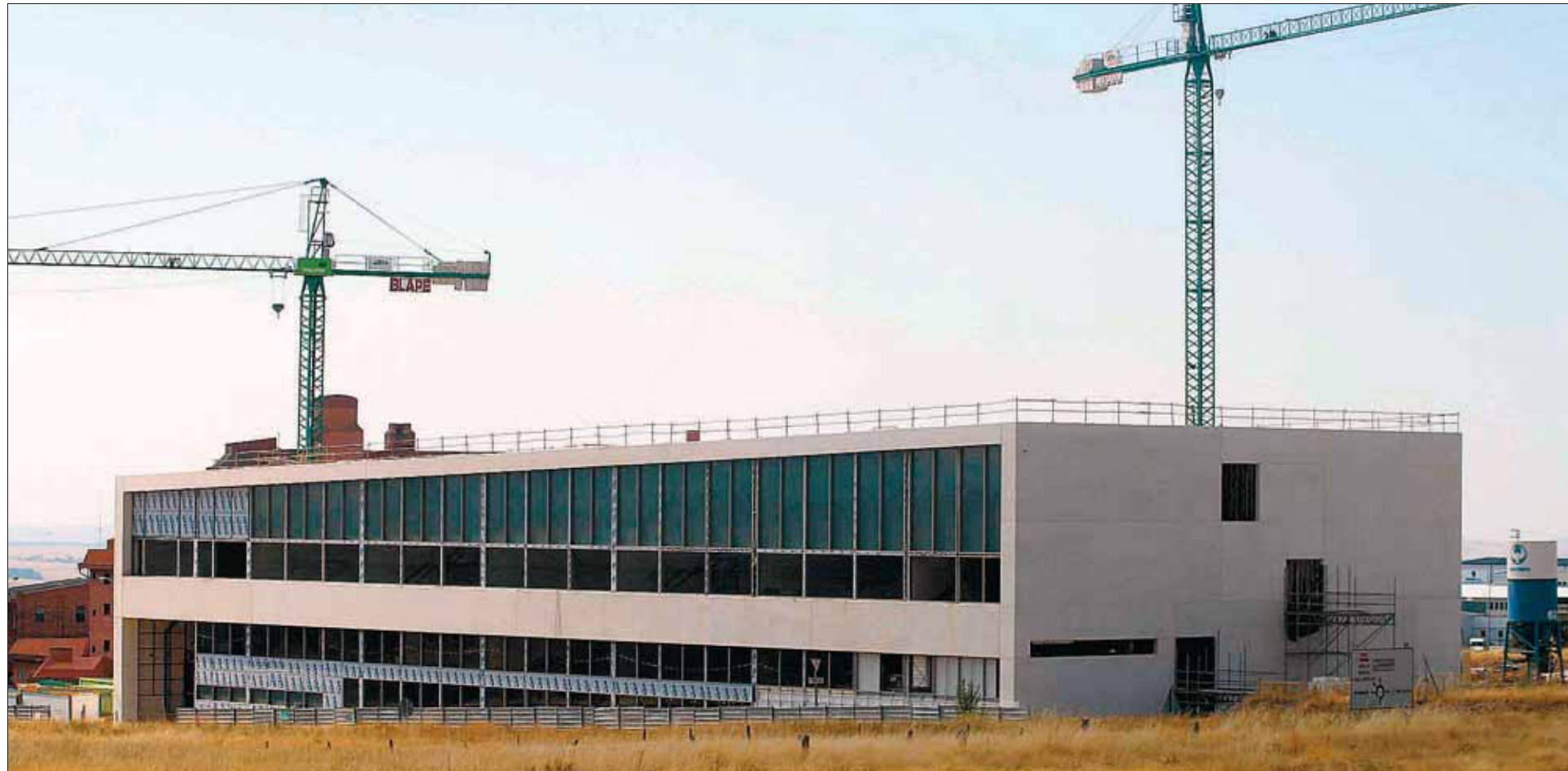
Las obras del Centro de Innovación Empresarial (CIDE), el primer edificio del CAT, fueron paralizadas a principios de verano tras la liquidación de Volconsa, adjudicataria de las obras. / LARA MAZAGATOS
