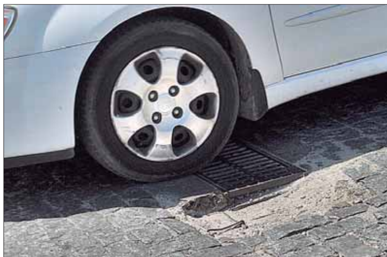
Los desperfectos que presenta la calzada son evidentes. / KAMARERO
