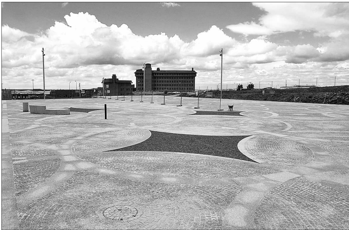
El Ayuntamiento ha concluido las obras de reurbanización parcial de los terrenos del CAT. / ALBERTO BENAVENTE
