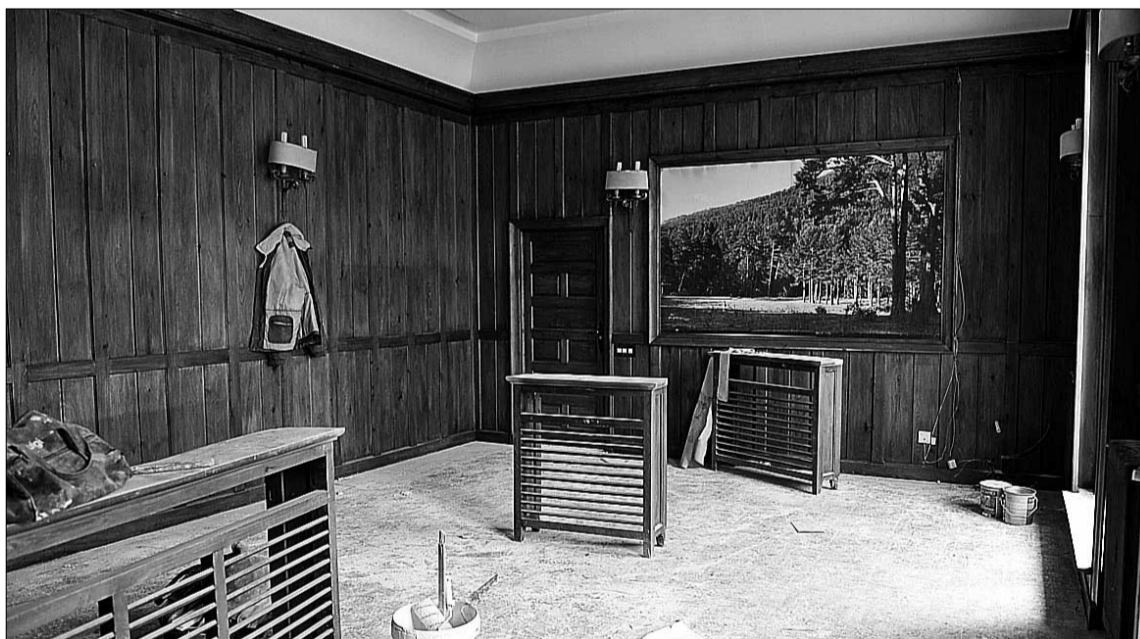
Estado actual del despacho del alcalde David Rubio, en la segunda planta del edificio. /PEDRO L. MERINO
