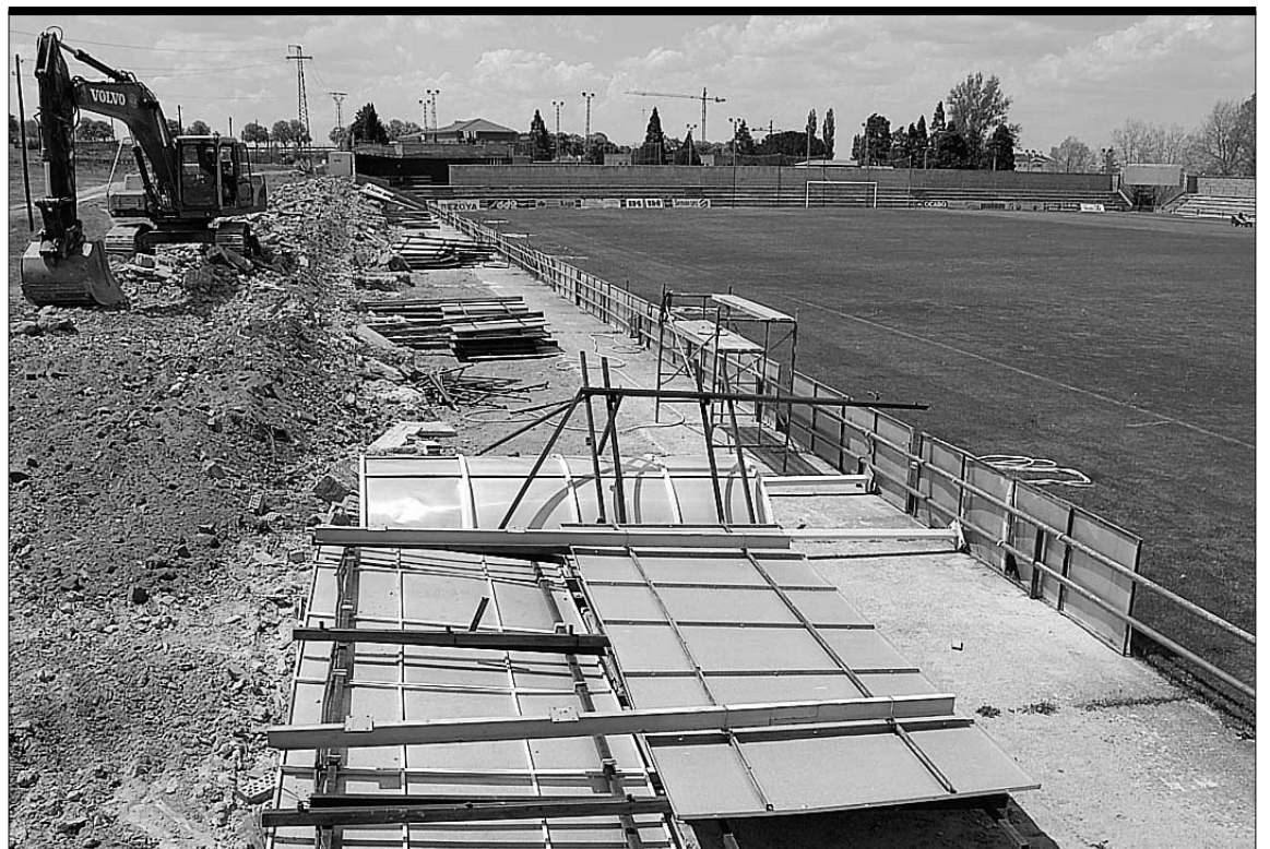
Continúan las obras en La Albuera. Ayer se concluyó el derribo del muro de la grada lateral descubierta del campo de fútbol de La Albuera, siguiendo así con los trabajos de construcción del nuevo estadio, que empezaron con la demolición del graderío. / FOTO: JUAN MARTÍN
