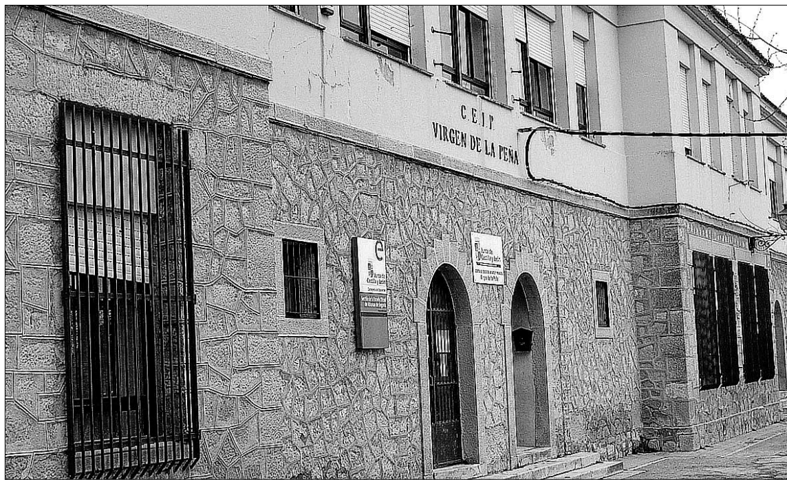
La cubierta del viejo colegio será reparada con cargo al Fondo Estatal de Inversión Local. / EL ADELANTADO
