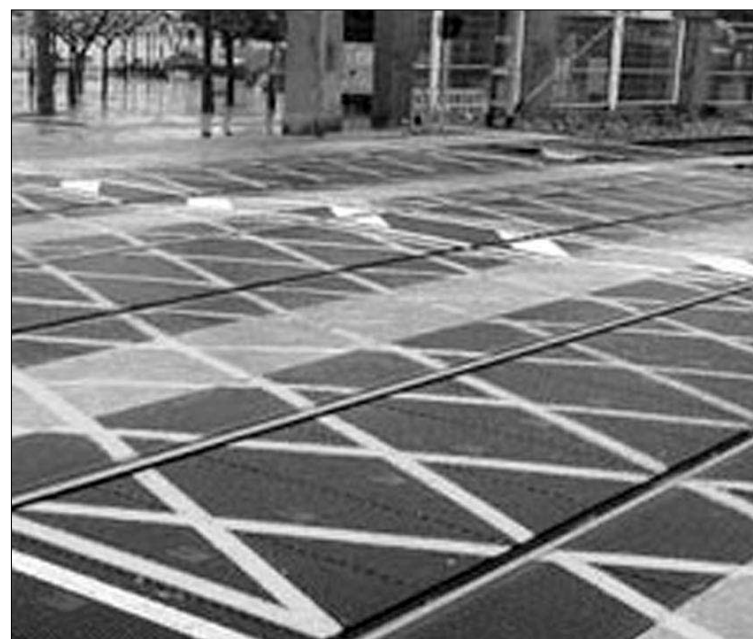
Imagen de un pavimento de caucho instalado en un paso a nivel. / EL ADELANTADO
