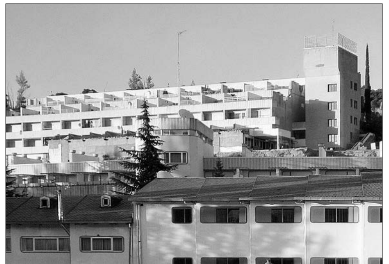
Imagen del inmueble donde aparecieron grietas y tuvo que ser desalojado. / P.M.
