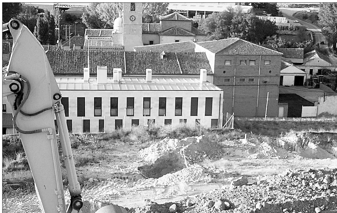
Los trabajos se están centrando en la ladera y el cerro situados detrás del antiguo frontón. /ÁLVARO PINELA
