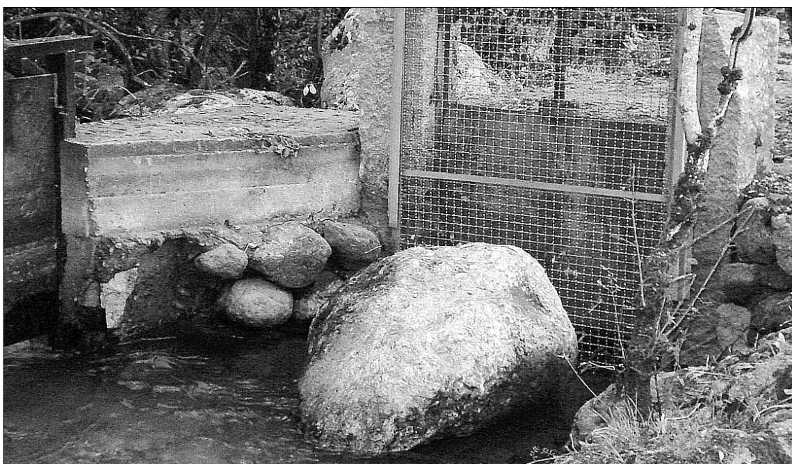
Los vándalos colocaron una piedra de más de una tonelada en la captación de la ETAP. /EL ADELANTADO
