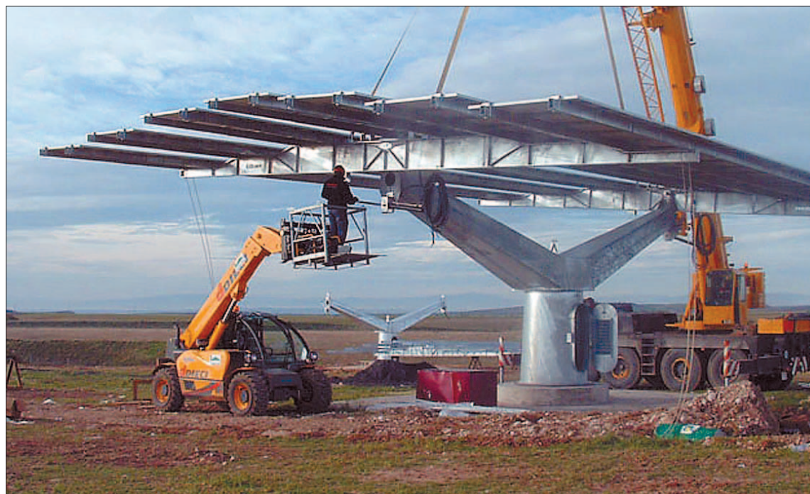
Imagen de la instalación de una de las placas solares de la empresa segoviana. / EL ADELANTADO
