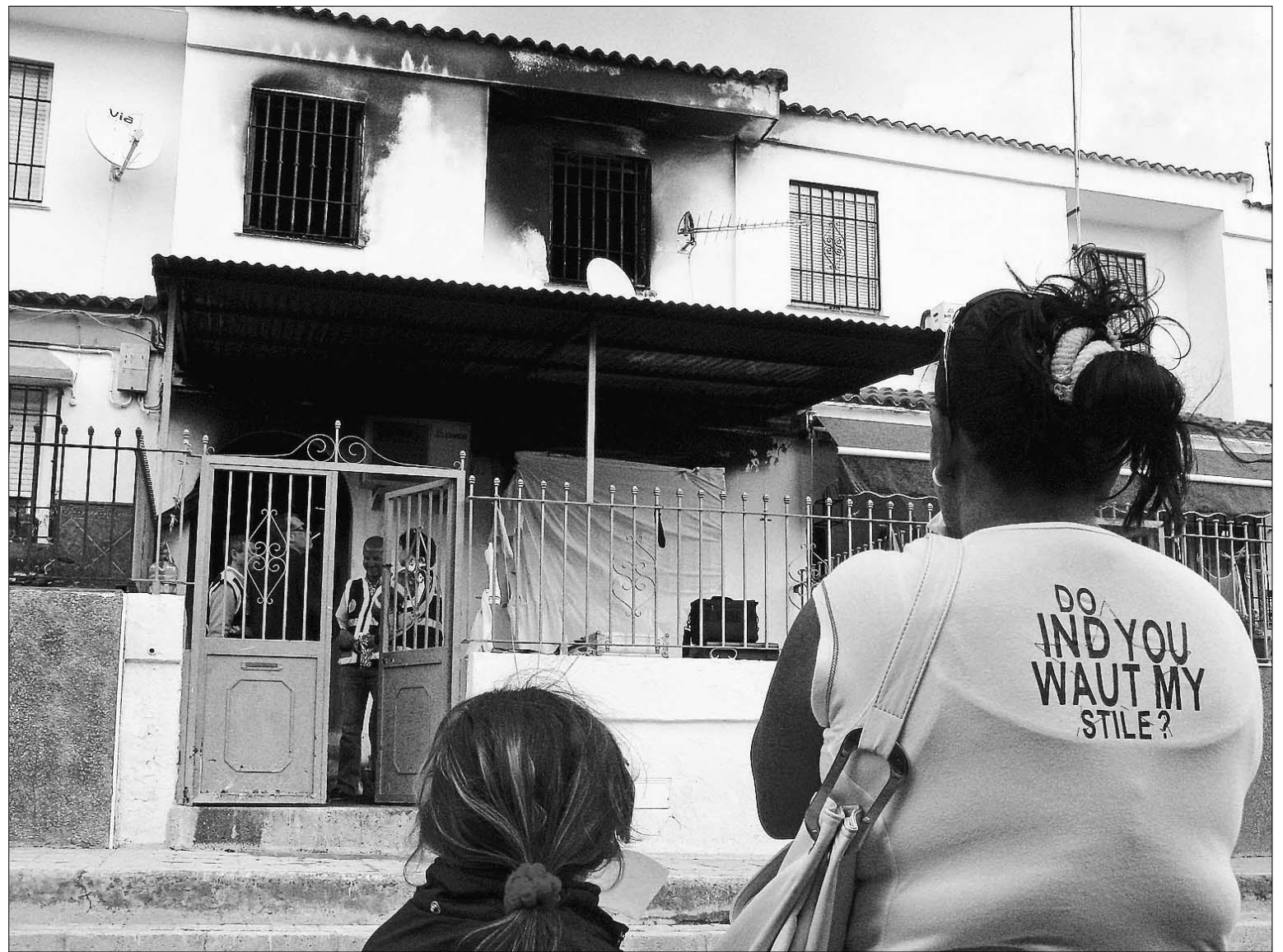
Estado en el que quedó la vivienda incendiada. / EFE
