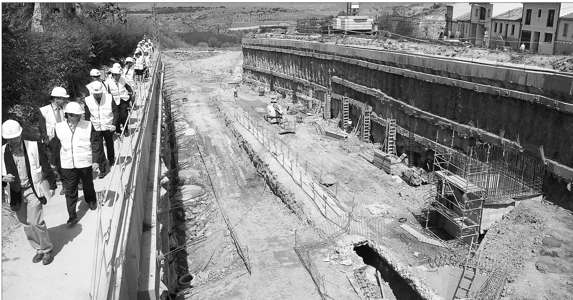
Los arquitectos e ingenieros responsables del proyecto acompañaron al alcalde y a los periodistas en una visita a las obras que se están realizando en el futuro aparcamiento. / JUAN MARTÍN
