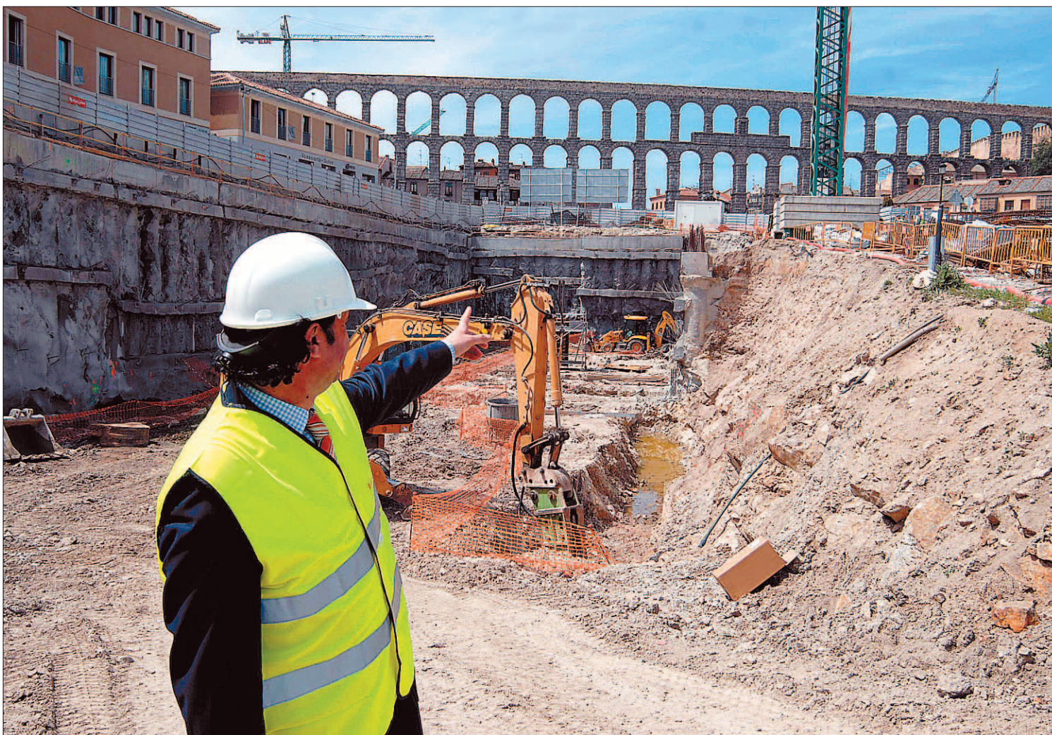
El alcalde Pedro Arahuetes muestra el estado de los trabajos en el aparcamiento, con el Acueducto al fondo. / JUAN MARTÍN
