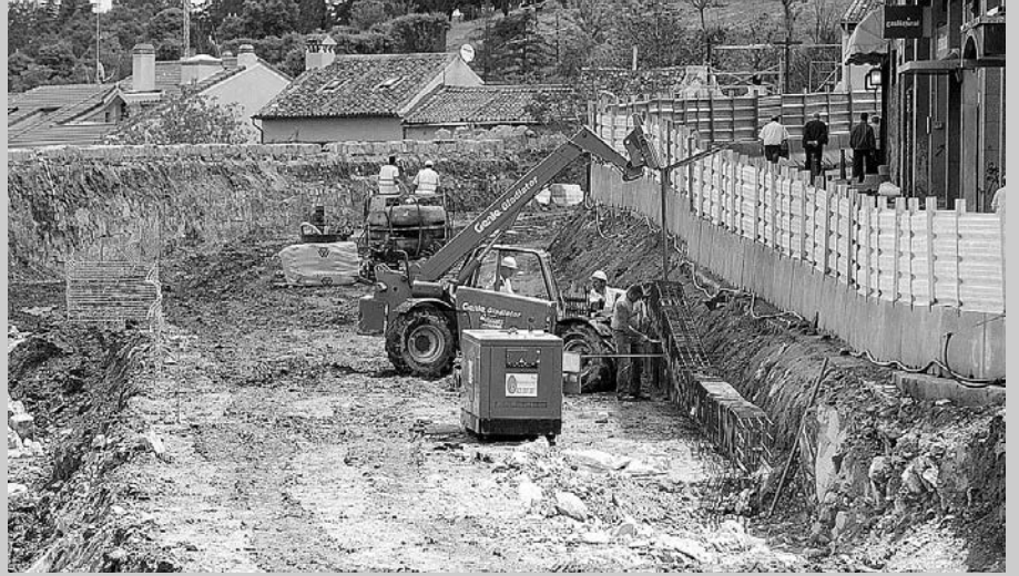
En apenas un mes, a mediados de mayo de 2007, los avances de las obras ya se hacían evidentes. Las máquinas eliminaron el muro de piedra entre Padre Claret y Vía Roma y comenzaron la excavación, que se prolongaría por espacio de varios meses. / JUAN MARTÍN
