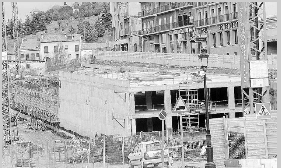
Cinco meses después, la estructura del aparcamiento es bien visible, con una de las zonas, la más próxima a la Plaza de la Artillería, ya terminada; la semana pasada comenzaron a ejecutarse los forjados de la siguiente zona, a continuación de lo ya realizado. / KAMARERO
