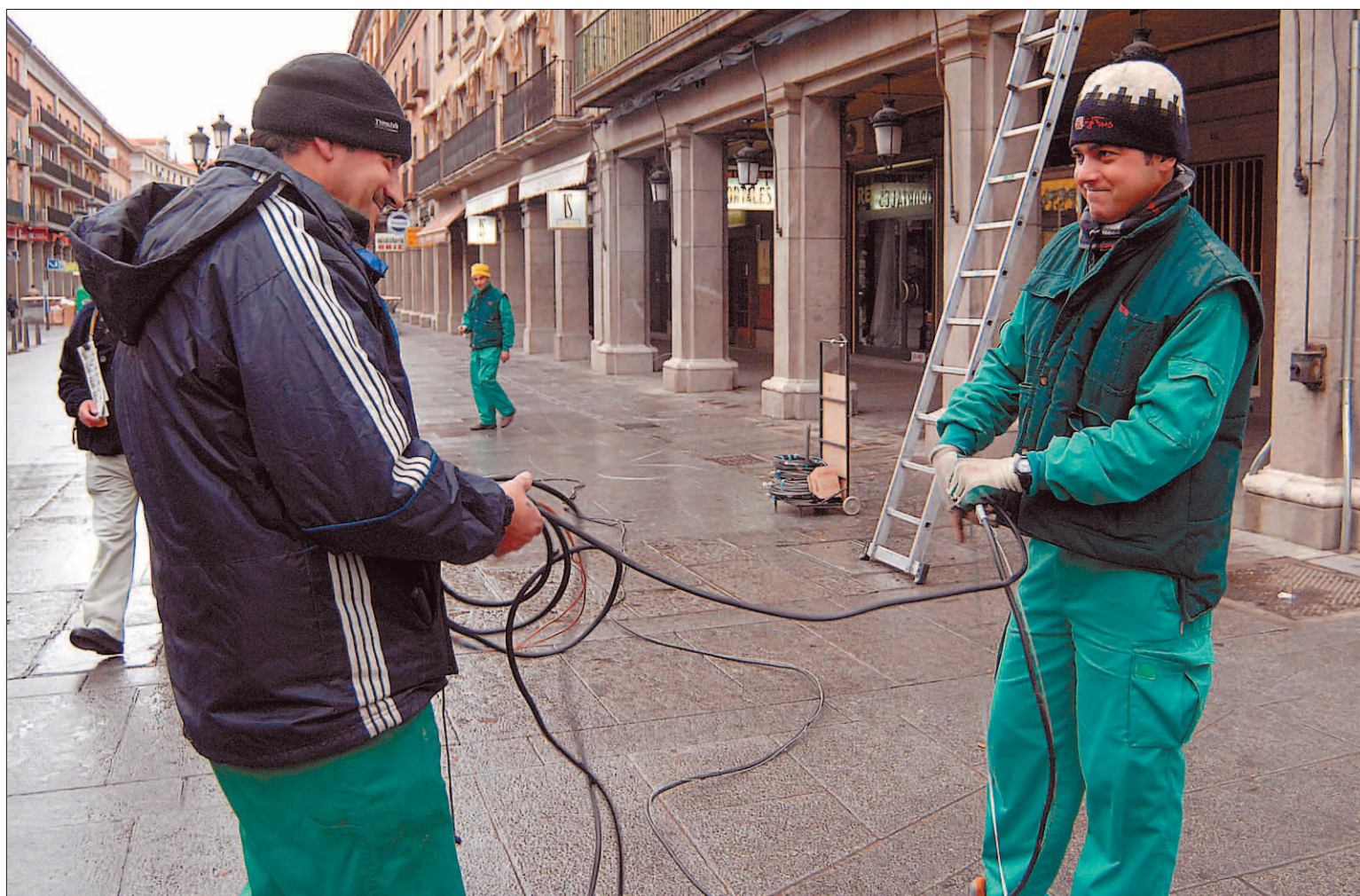
Dos trabajadores de la empresa "Carmelo Plaza", ayer en Fernández Ladreda, con las labores de cableado previas a la instalación de los arcos lumínicos // JUAN MARTÍN
