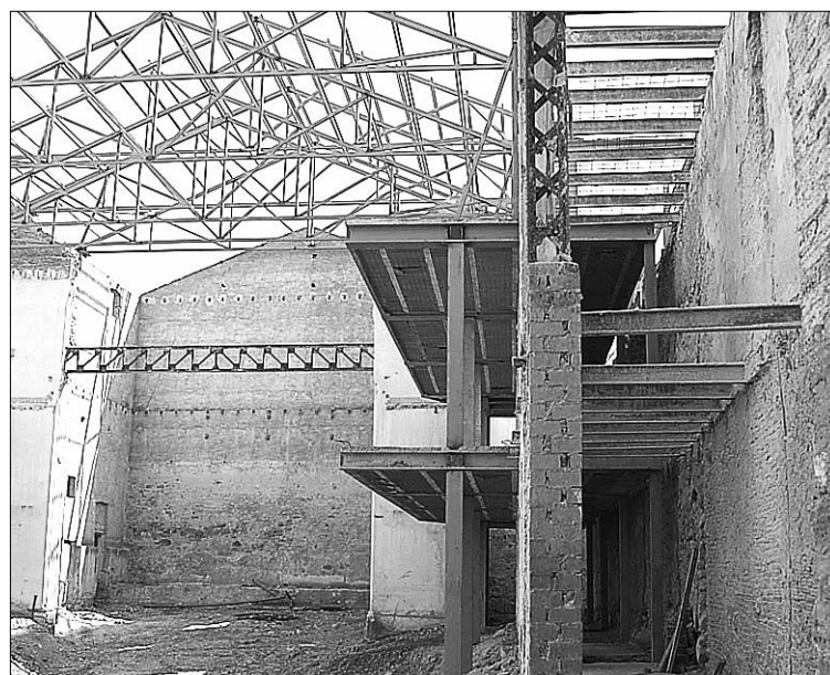
Las obras fueron paralizadas hace más de un año por la Junta. / JUAN MARTÍN
