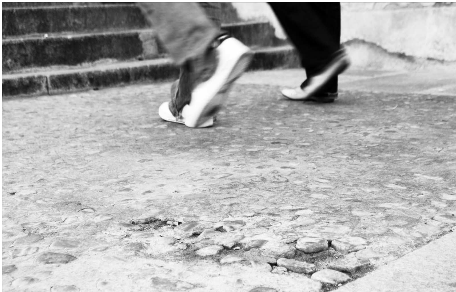
Las plazas de San Martín y Medina del Campo presentan numerosas zonas donde el firme presenta un evidente estado de deterioro/KAMARERO
