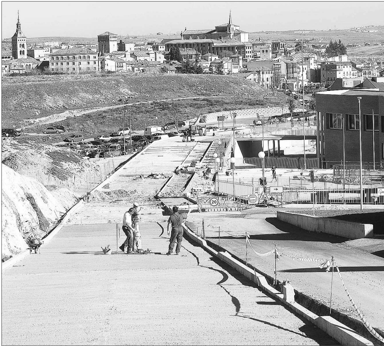
La calle trazada en el antiguo Camino de Perogordo será la vía de comunicación que dará paso a los edificios de consultas (primera pasarela)
