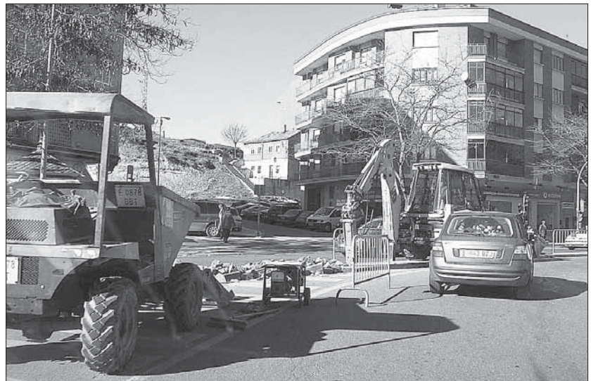
Las primeras obras se dirigen a adecuar la zona para la regulación del tráfico que se aplicará a partir del lunes/JUAN MARTÍN
