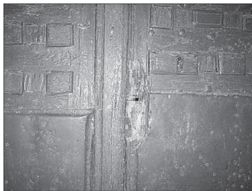
Puerta de entrada donde se puede observar los daños ocasionados. / A.P.
