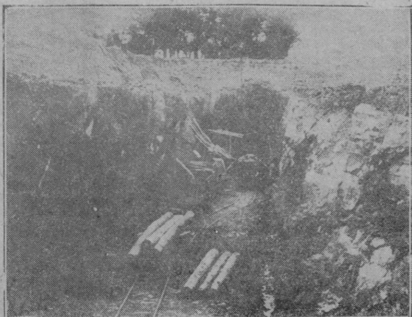
Boca del túnel de Encinacorba que se hundió hace pocos días, sepultando bajo los escombros a varios obreros, de los cuales han podido ser salvados un número reducido.
