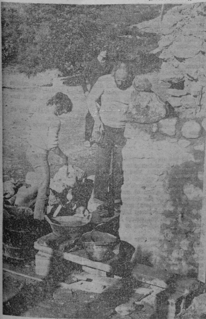
Los chicos alemanes con su "monitor" construyendo un edificio que servirá de culto para los católicos. Los chicos pertenecen a la Iglesia Evangélica.
