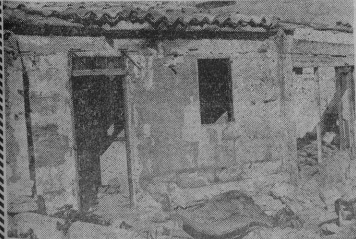
Una de las innumerables casas de la barriada de Ca'n Perentoni. Obsérvese su estado ruinoso y la multitud de escombros
