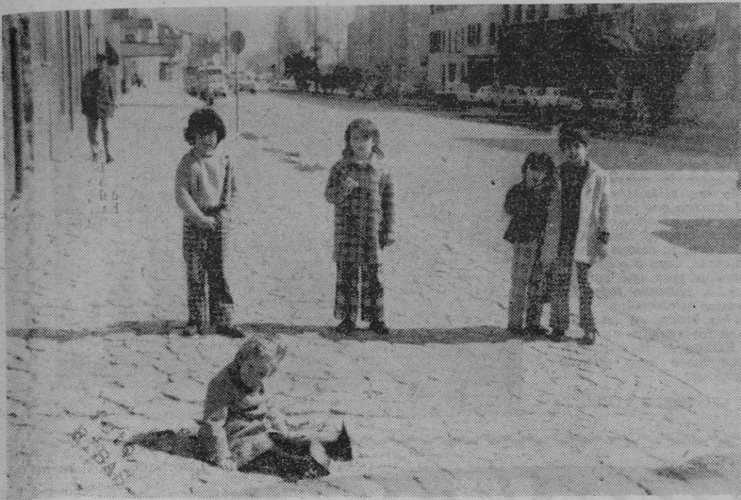
Véase el estado en que se encuentra la acera de la calle de Héroes de Manacor.
