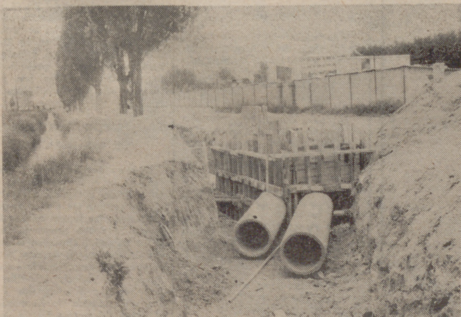
Las obras de entubado están a punto de terminarse en las Delicias.
