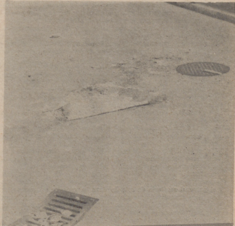
El atasco de los desagües, debido a la basura, puede originar serios problemas en caso de tormenta o lluvia fuerte.
