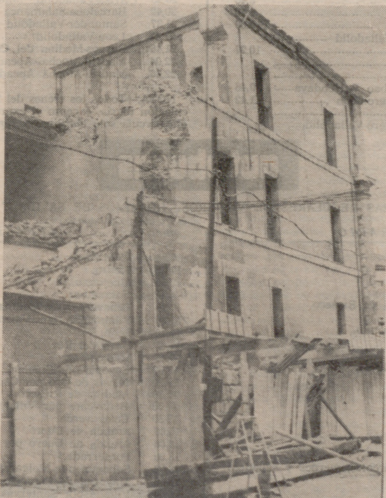
Hace días informábamos a nuestros lectores del hundimiento producido en el antiguo Cuartel de San Quintín, Hospedería de San Benito. El peligro de desplome de alguna parte del edificio, por la parte que da frente al edificio de Correos, ya está siendo evitado al realizarse esta mañana los trabajos de derribo de la zona afectada. En la foto de Carvajal se pueden apreciar los trabajos efectuados
