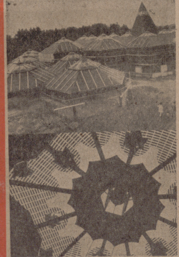
WIGRATZBAD.—(DaD).—En la pequeña localidad alemana de Wigratzbad se está construyendo una iglesia que, por su sencillez y originalidad, ha merecido grandes elogios dentro y fuera de la República Federal. En la fotografía de abajo aparece la torre de la iglesia vista desde el interior, y en la superior se recoge el estado actual de las obras. Wigratzbad es uno de los centros de peregrinación más visitados de Europa central, ya que, según la leyenda, posee una fuente milagrosa. La actual iglesia del lugar, muy modesta, pues Wigratzbad tiene solamente 200 habitantes, fue construida en 1936 por una joven campesina en acción de gracias porque recobró la libertad luego de haber sido detenida por la tristemente célebre Gestapo. Aunque la iglesia no ha reconocido oficialmente este lugar de peregrinación, la "vox populi" afirma que la Virgen se apareció en 1936 a la joven campesina y le señaló el lugar donde debía ser construido un templo.
