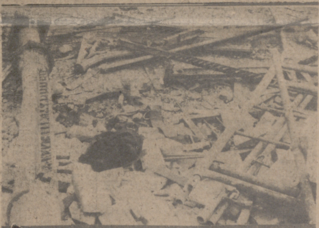
A las seis y media de la tarde de ayer, y cuando los obreros que trabajan en el desmantelamiento del Mercado de Portugalete estaban a punto de terminar su jornada, se hundió parte de la estructura metálica. En el suceso perdió la vida uno de los trabajadores.
