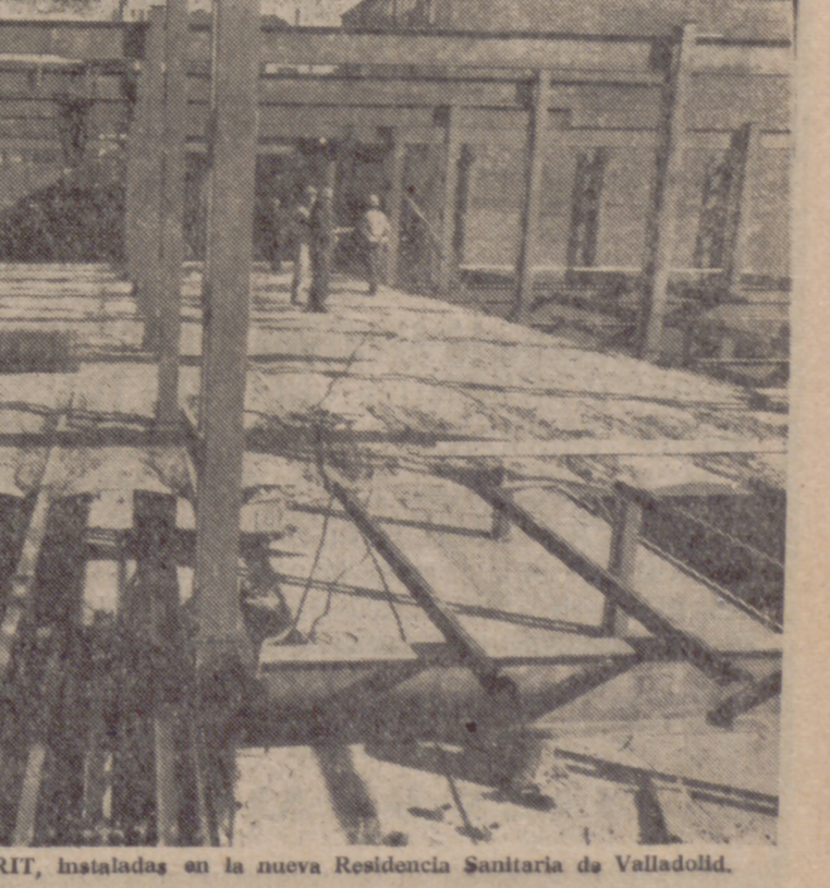
Bovedillas de fabricación IBERIT, instaladas en la nueva Residencia Sanitaria de Valladolid.
