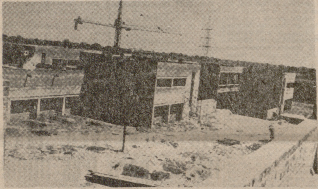
Obras de la Escuela Profesional de Sevzi, con la grúa importada de España.—(Foto PYRESA.)
