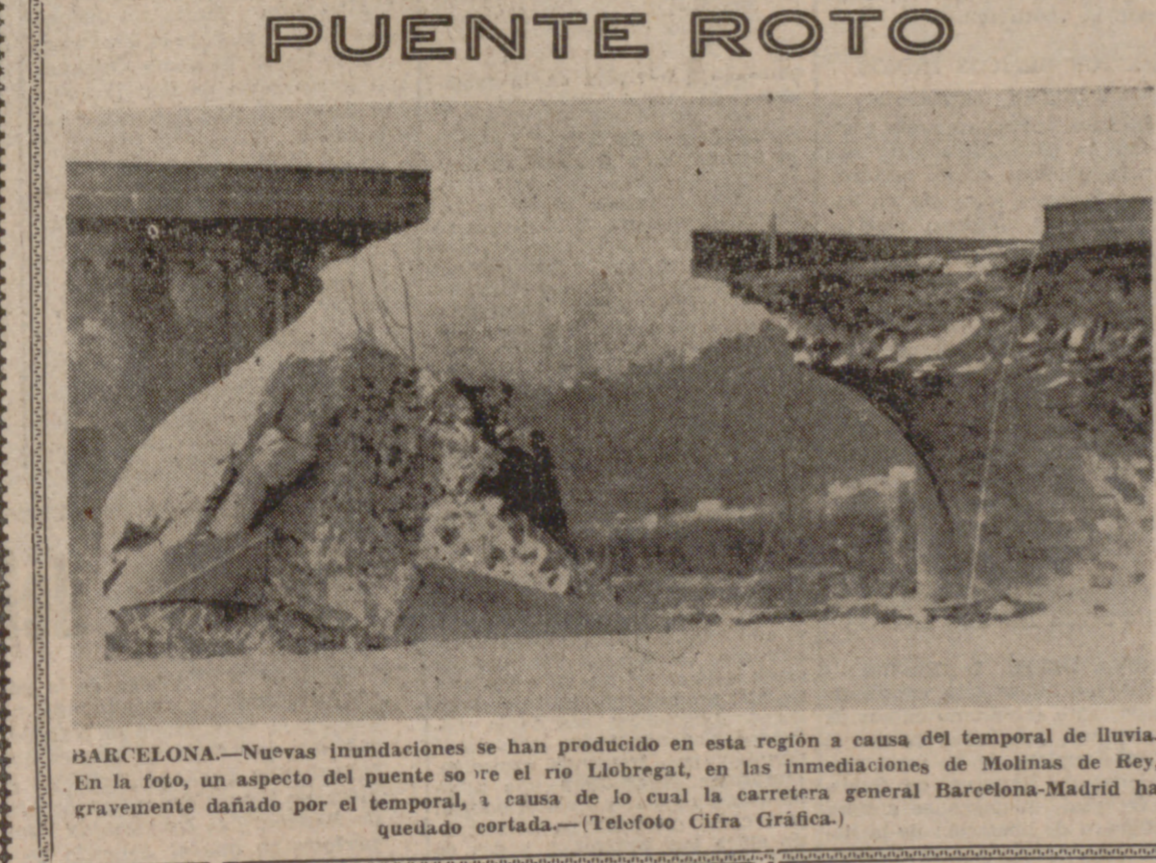
BARCELONA.—Nuevas inundaciones se han producido en esta región a causa del temporal de lluvia. En la foto, un aspecto del puente sobre el río Llobregat, en las inmediaciones de Molinas de Rey, gravemente dañado por el temporal, a causa de lo cual la carretera general Barcelona-Madrid ha quedado cortada.—(Telefoto Cifra Gráfica.)
