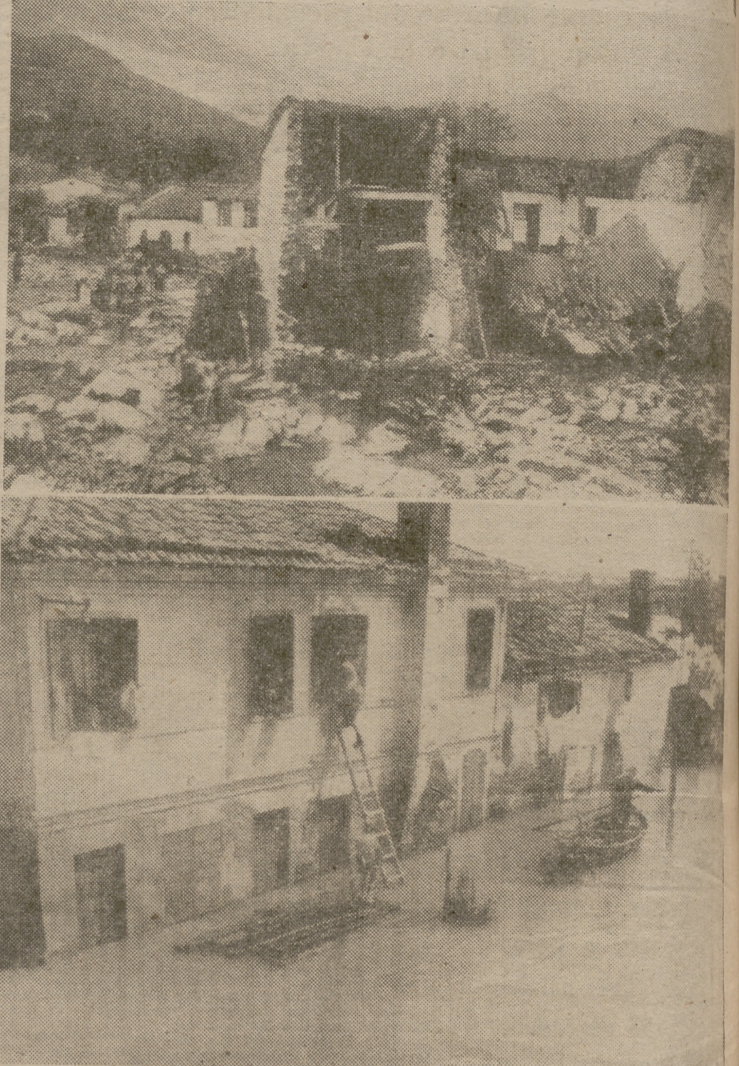
Este es el aspecto en que ha quedado una de las casas de Ramales (Santander), al ser alcanzada por el trágico desbordamiento de las aguas del río Gándara. La otra fotografía está tomada en Gavenier, situada en el delta del Po, al norte de Italia, en el momento en que los granjeros de aquella zona intentan salvar lo que pueden en su huida por el empuje de las aguas, que dejarían sin hogar a miles de personas, poniendo en riesgo sus vidas e inundando sus tierras. (Foto Cifra.)
