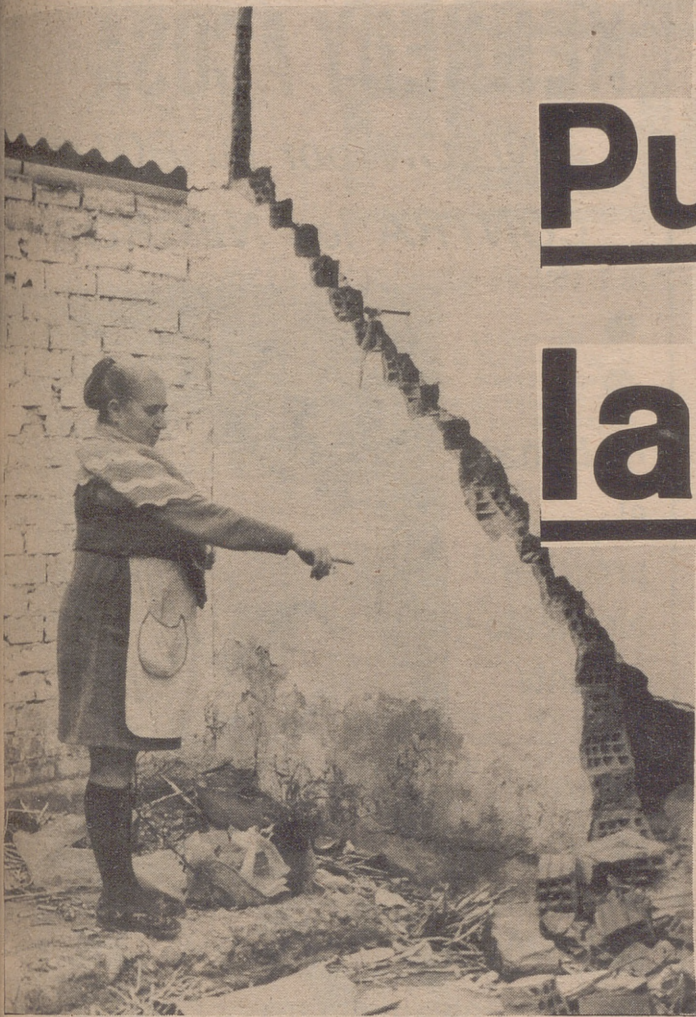
Doña Eulalia nos señala las enormes grietas que amenazan el patio de su vivienda. Lleva veintiseis meses viviendo de favor en casa de unos vecinos.
