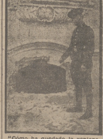
"Cómo ha quedado la ventana del edificio en reparación de la calle de María de Molina, núm. 44, donde anteanoche hizo explosión una bomba." (Foto Díaz Casariego.) (De "A B C" del 26 de octubre de 1933.)
