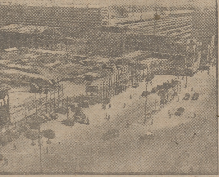
Hace diez años comenzaron las obras de construcción de la gigantesca estación central de Roma, que será la mayor de Europa. Se tiene el propósito de que esté terminada para el Año Santo de 1950. En la foto, una vista de dichas obras.
