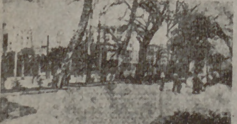
Trabajos de reforma en la Alameda de Oviedo. Se ven los árboles y las obras de construcción.
