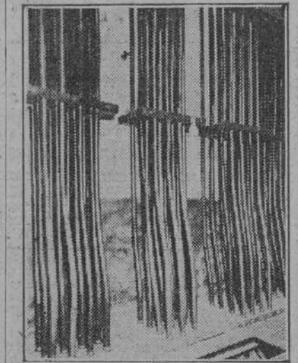
Cables que contienen más de 26,000 pares de alambres, entrando en la Oficina Central de Aguilá, desde el subsuelo.
