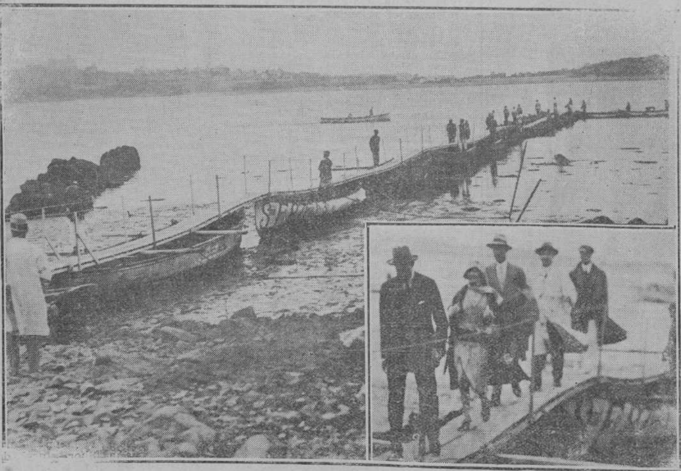
Desembarcadero construido en Pedreña para que el Soberano pudiera desembarcar. Las obras de este desembarcadero fueron dirigidas por el conde de Solámani y con la cooperación de los vecinos, que trabajaron durante toda la noche.—En el ángulo, el momento en que el Rey cruza el desembarcadero. (Fotos Alejandro).
