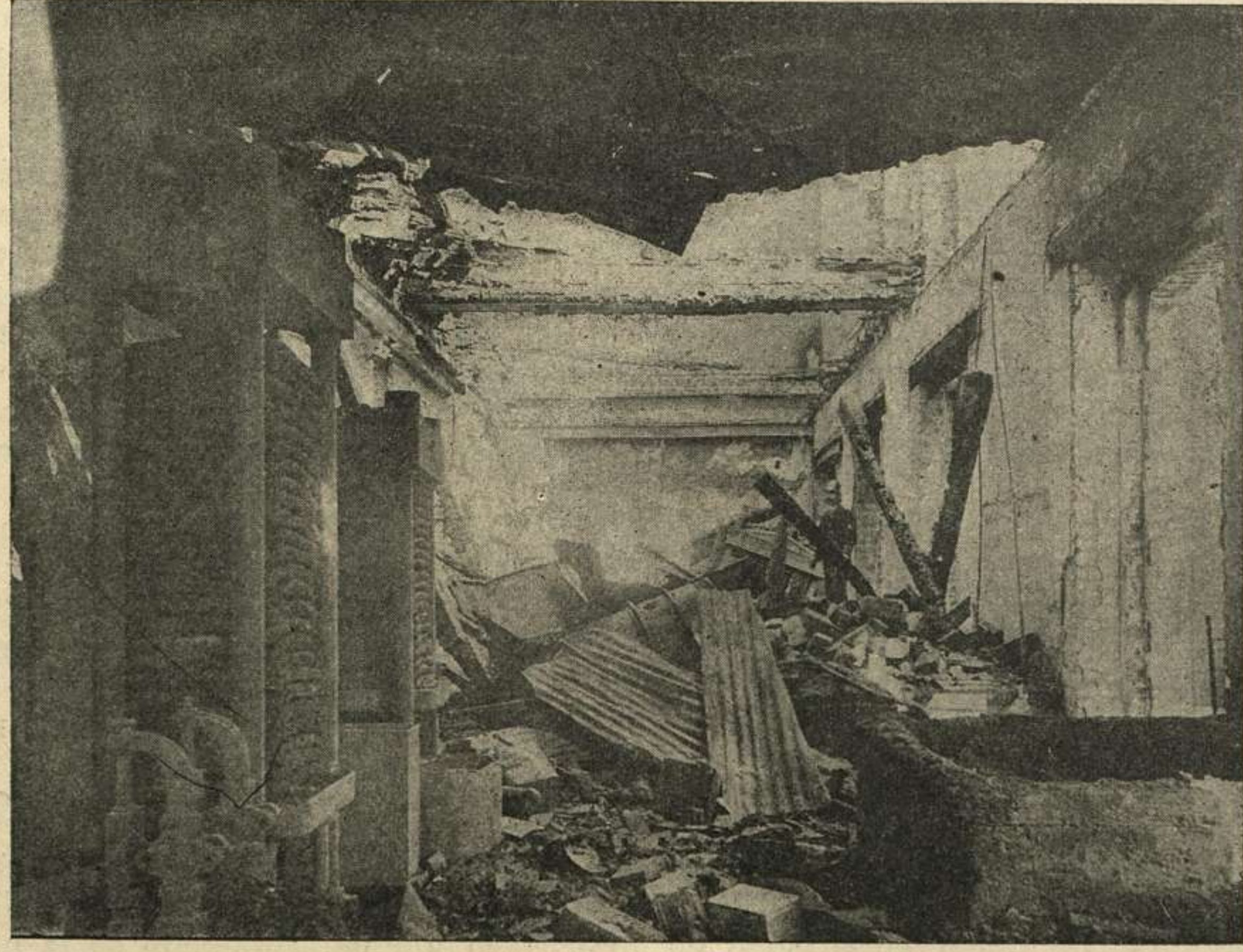
Estanques de aceite incendiados.
