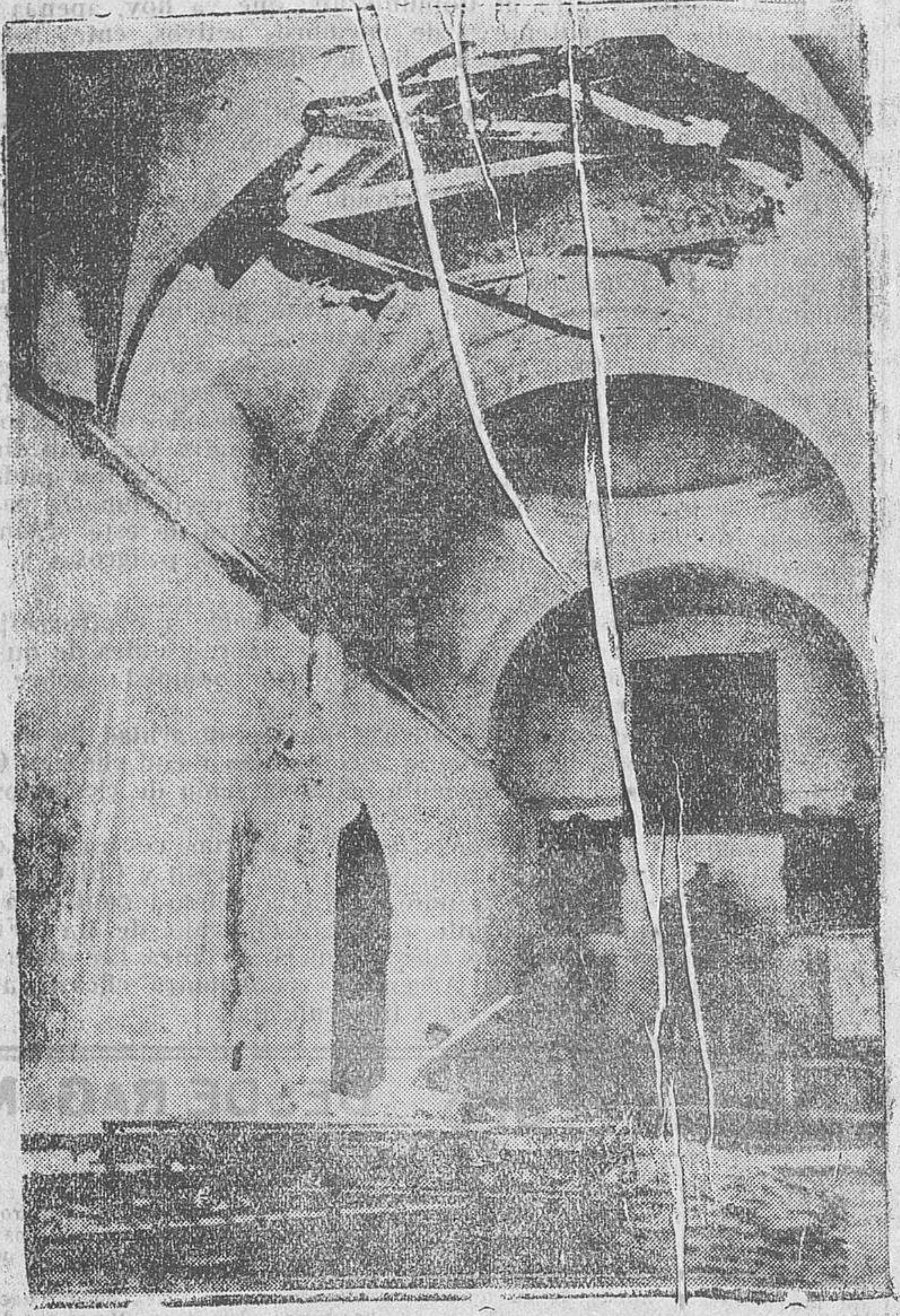
MOTRIL.—En el bombardeo rojo sobre el hospital de Motril, el día 17 de Junio de 1937, una de las bombas cayó en la capilla, pero no hizo explosión
